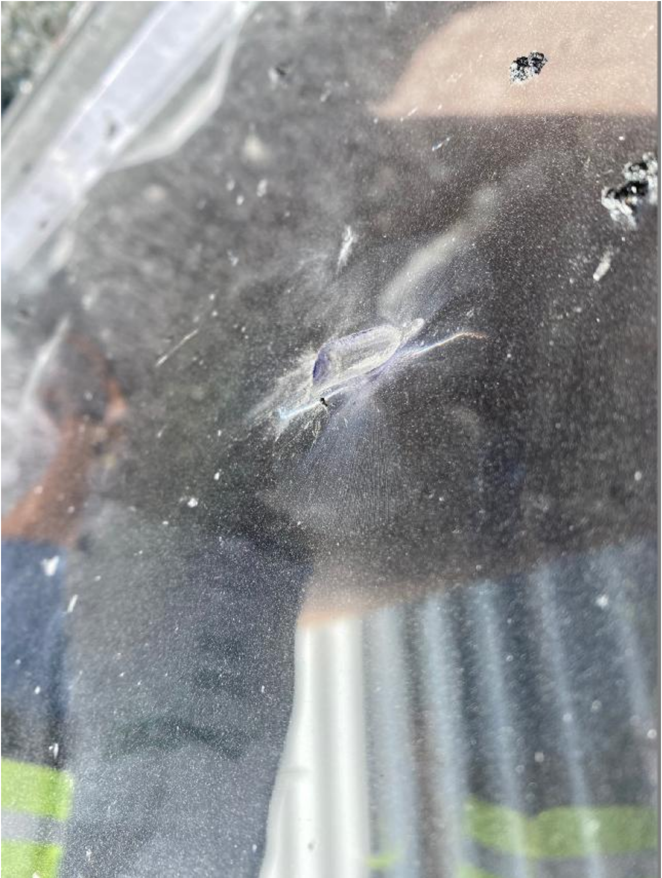
Bilde 6. Vindu fikk kun en mindre skade hvor det gikk et skall av i overflaten. Skaden måler ca. 1x2 cm.
